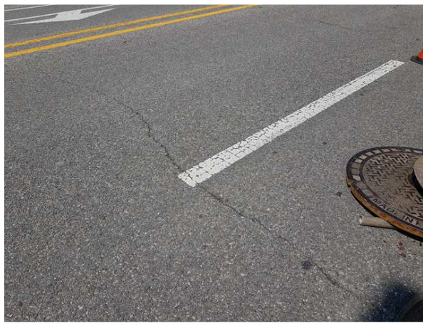
내용 포장부 아스콘 균열
